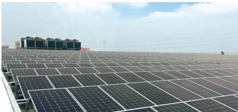
华润江苏医药物流中心屋顶分布式光伏发电项目
